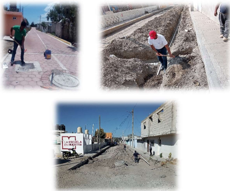
Figura 1.1. Realización de diferentes mantenimientos a la red de agua potable en la cabecera municipal.
